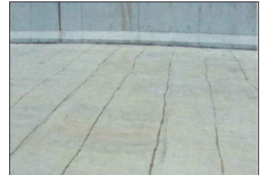
床版上のひびわれ
